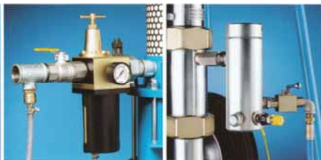
Jedinica za održavanje zraka je instalirana na pumpi.
